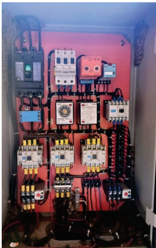
Figura 2. Tablero eléctrico con los componentes en buen estado.
