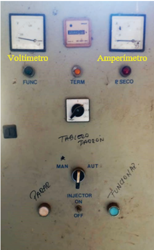
Figura 1. Tablero eléctrico, voltímetro y amperímetro.
